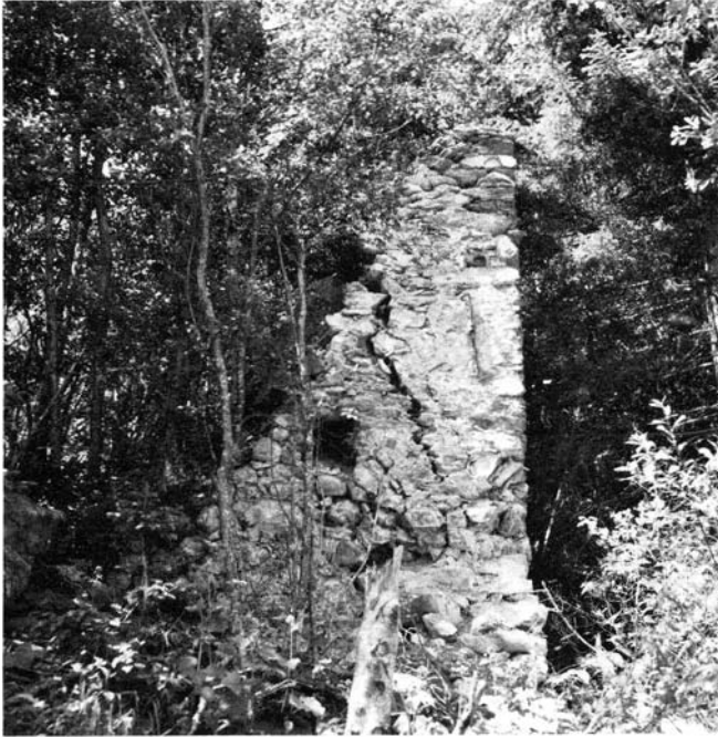
Die recht auffällige Ruine des untern Schmelzofens kann nur noch durch rasche Sanierungsmassnahmen gerettet und gesichert werden.
